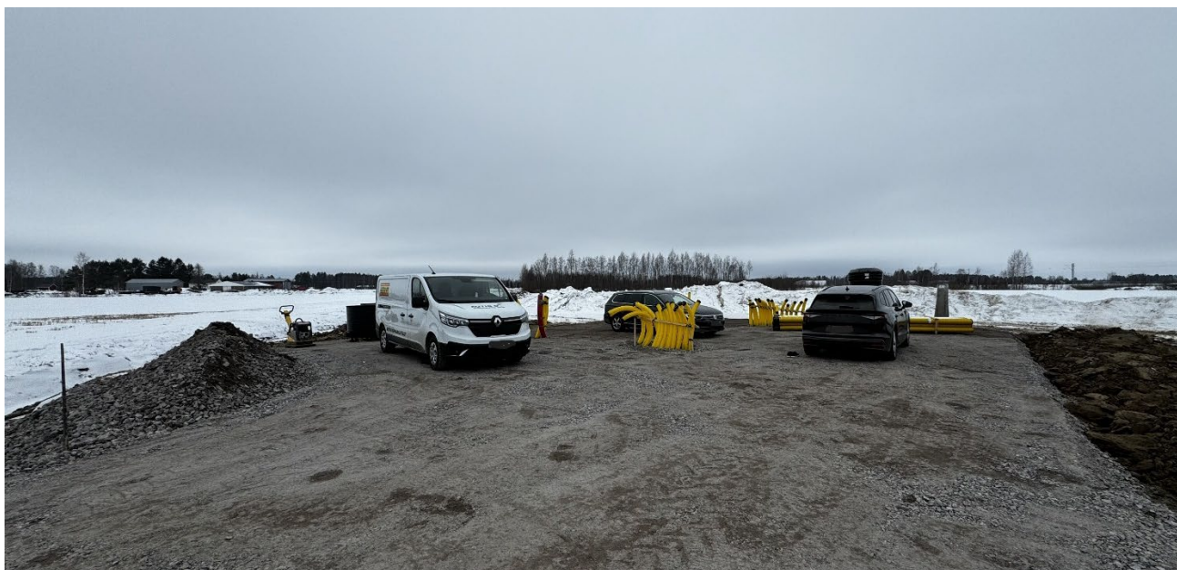
Maarakennustöiden jälkeen valmis muuntamokenttä Ruotsinojan aurinkopuistossa talvella 2024
