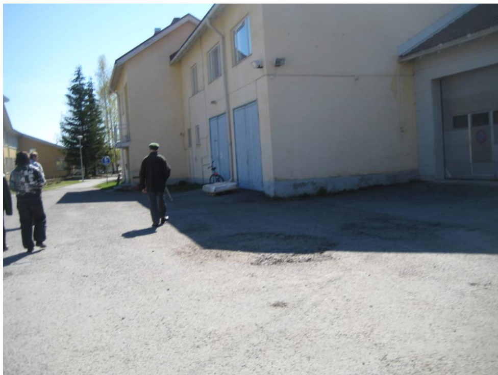
Kuva 27. Kunnankujan lop- puosa – epäta- saisuutta ja pintavaurioita, (kompastumis- vaara), kaut- taaltaan sama pintamateriaali on heikkonäköi- sen vaikea hahmottaa (ohjaavuuspuu- te). (kohde B4 )
