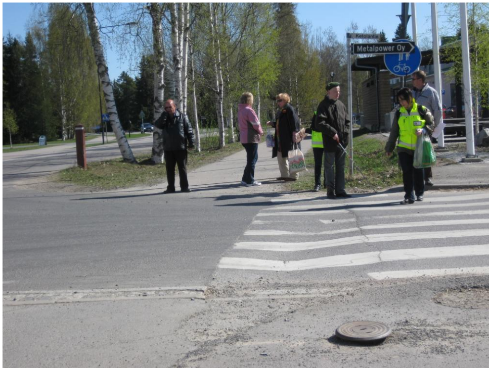
Kuva 22. Suojatie kevyen liikenteen väylän jatkona puuttuu. Ketolantiellä viemärilinjalla painumavauriota, venttiilikansi koholla ja viemärikansi kuopalla jalkakäytävän päällystepinnasta. (kohde B3)
