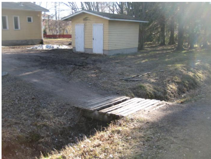
Kuva39. Kirkkotie 1 kiinteistöltä johtavan oikopolun silta on liikumisesteiselle vaarallinen. (kohde A6)
