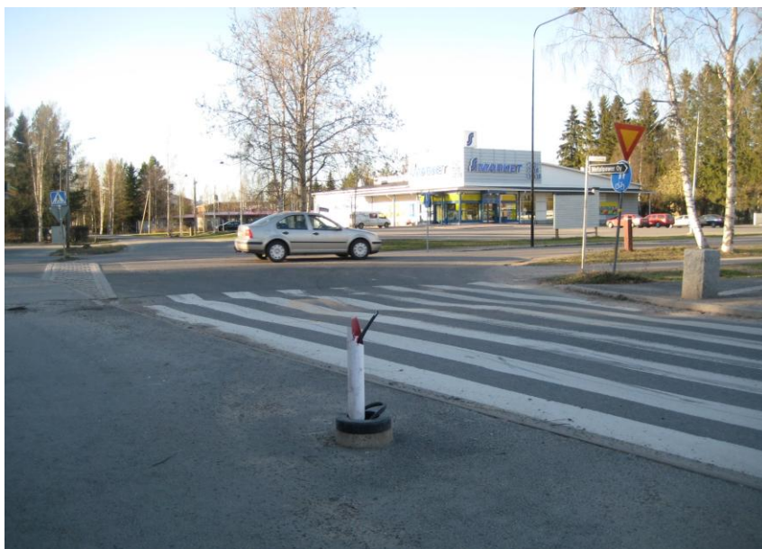
Kuva 3. Poistetun valaisinpylvään ”torso”. Kohteeseen tullaan asentamaan uusi valaisin
