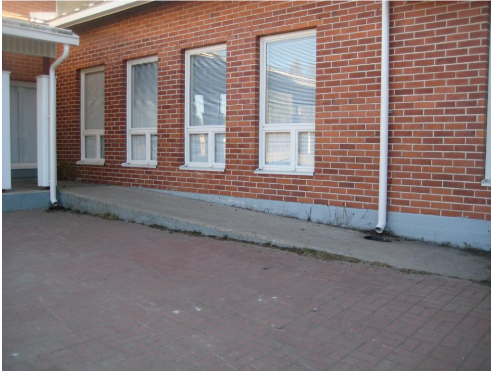
Kuva 43. Kuulammen koulun sisäänkäynti A, kaiteeton ja suojareunaton luiska. Syöksytorvesta roiskuva vesi jäätyessään voi aiheuttaa liukkautta luiskan alaosaan. (kohde D7).
