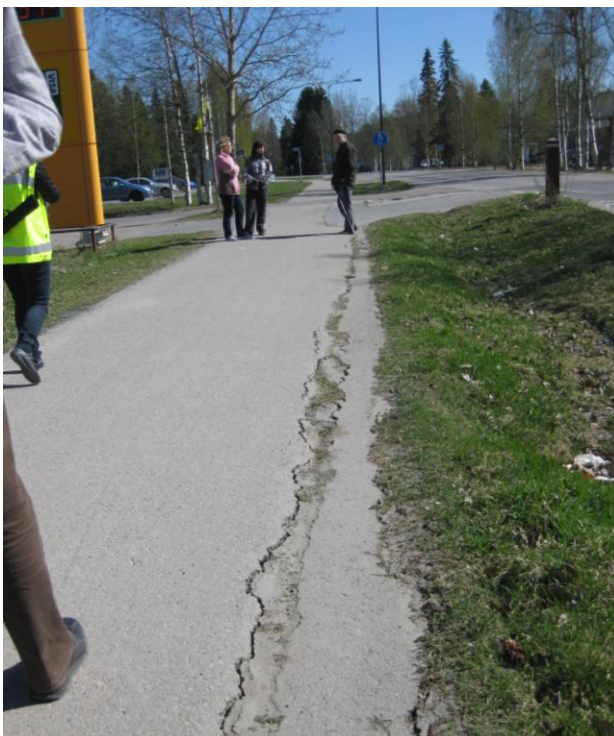
Kuva 18 vasemmalla. Kevyen liikenteen väylän pituussuuntaiset halkeamat ja reunan pettäminen Vanhatie 7 kohdalla. (kohde A2)
