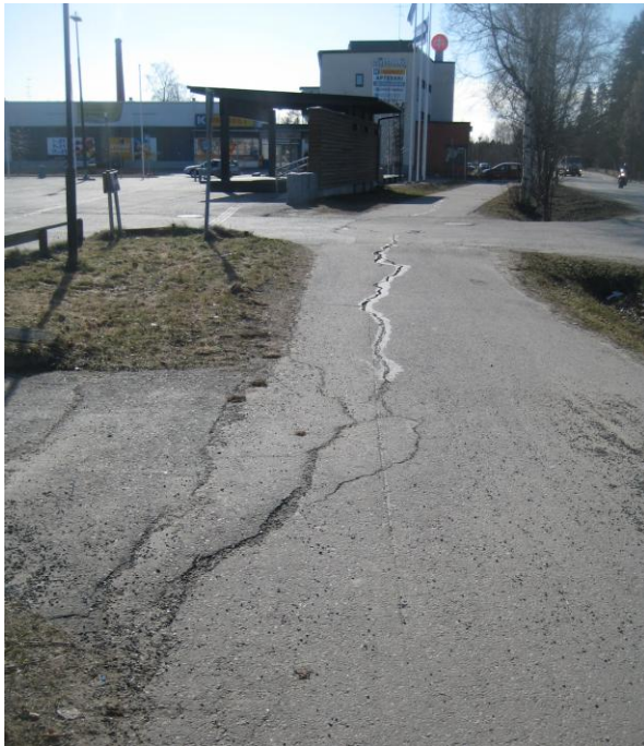
Kuva 2 Kevyen liikenteen väylien halkeamia ja pinnan epätasaisuuksia
