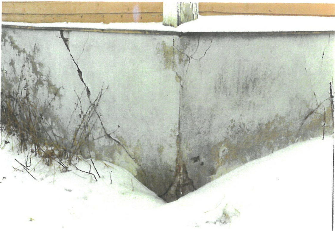
Kuva 22. Routavaurioita puuosan perusmuurirakenteessa pesulan koilliskulmalla.
