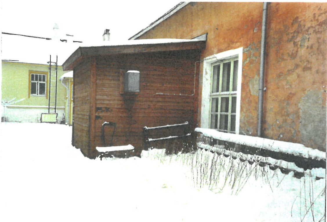
Kuva 29. Rapattua itäsivun ulkoseinäpintaa. Kalkkimaali on paikoin karissut rappauspinnalta.
