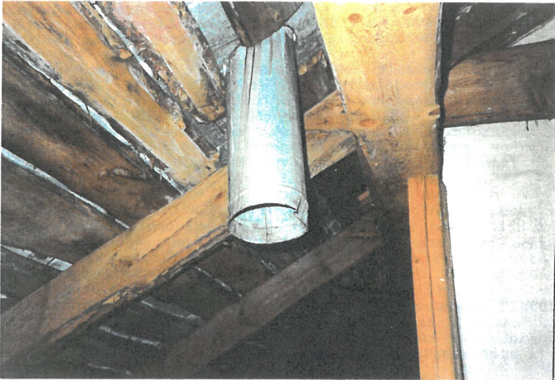
Kuva 41. Puuosan avoullakolla vesikatteen läpi menevä peltiputken kappale on aiheuttanut lahovaurioita alapuoliseen yläpohjarakenteeseen päästäessään sadevettä ja lunta yläpohjan eristekerroksen päälle.
