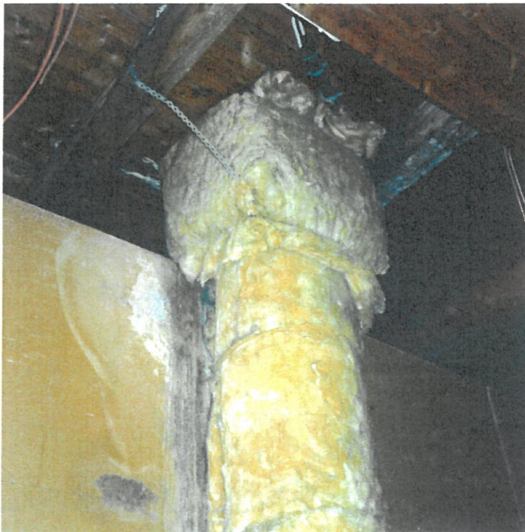
Kuva 40. Kuvan 39 vesikattovuodon jäljet kerrosta alempaan eli ullakkotilan 206 kohdalla.
