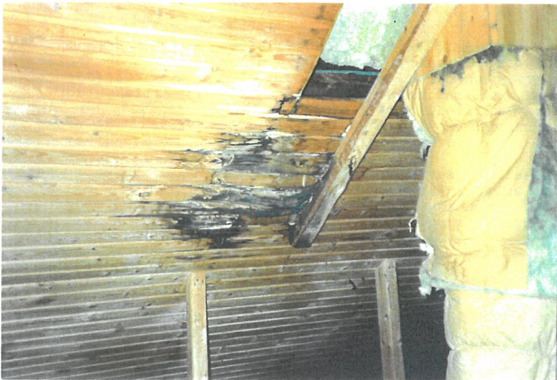
Kuva 36. Vesikattovuodon aiheuttama lahovaurio yläpohjarakenteessa soitinhuoneen 205 yläpuolella. Lahonneen puuverhouksen pinnalla esiintyy mm. laakakääpäkasvustoa.
