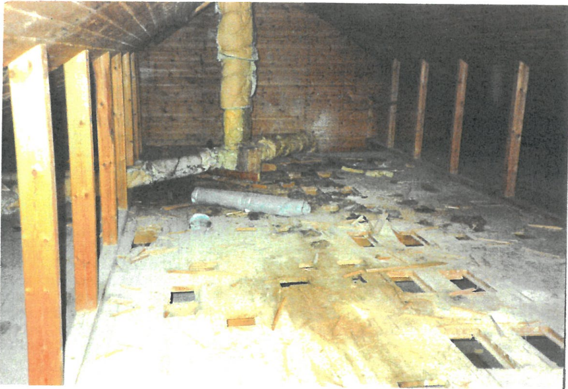
Kuva 35. Yleiskuva soitinhuoneen 205 yläpuolisesta ullakkotilasta. Lattiapinta on reikäinen ja ilmanvaihtoputken vesikatteen läpimenokohdan alapuolella osittain lahonnut.
