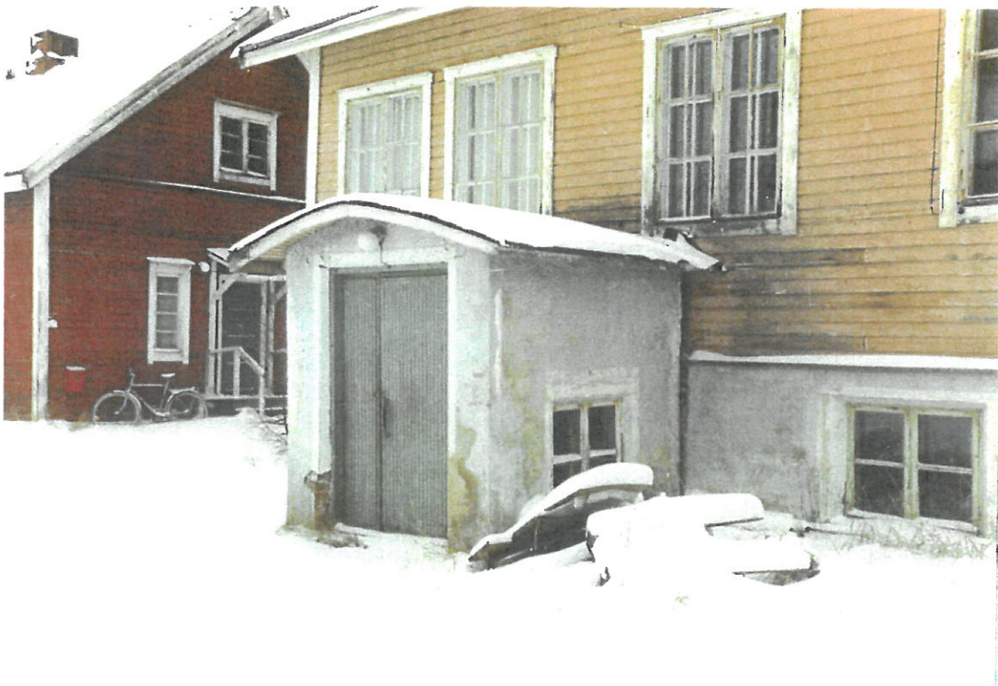
Kuva 23. Länsisivun porrashuone on perustettu routivalle maapohjalle. Pesularakennuksesta ulospäin kallistuneena porrashuone on purkuvalmis.
