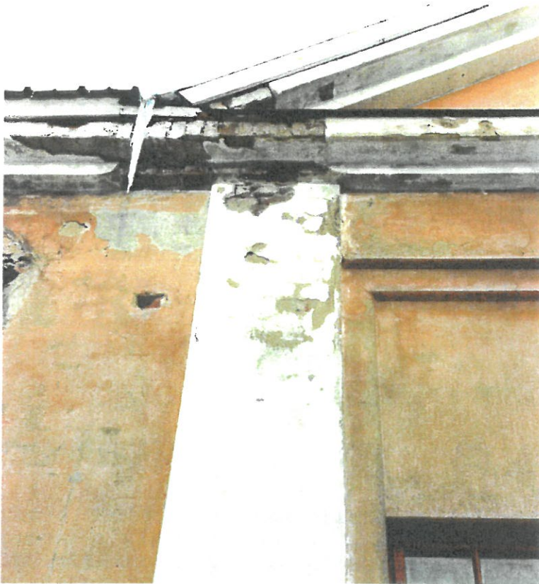
Kuva 10. Puutteellinen sadevedenpoistojärjestelmä on aiheuttanut vaurioita eteläpäädyn jiirin alapuoliseen ulkoseinära-kenteeseen.
