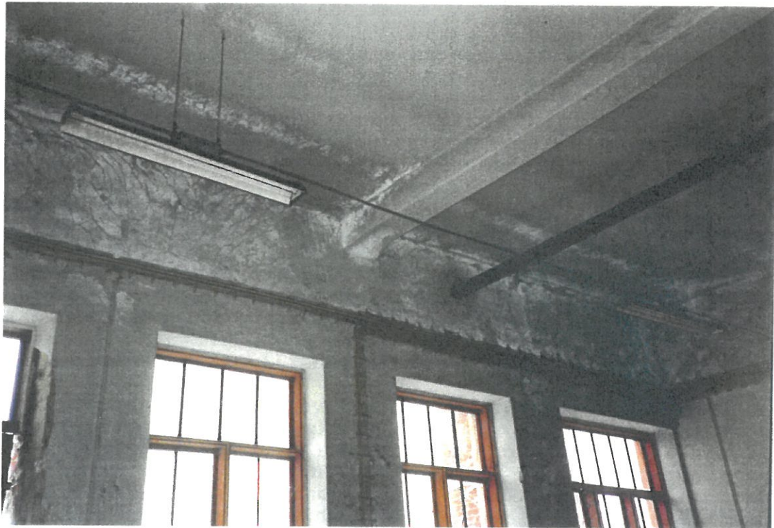
Kuva 14. Kylmäsiltoina toimivat kattilahuoneen yläpohjan alalaattaholviin liittyvät palkit näkyvät kattilahuoneen katossa valkoisen "härmeen" kohdilla.
