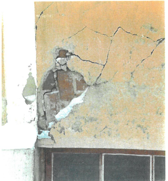
Kuva 8. Rappauksen halkeilua seinän alaosassa koillisnurkassa.
