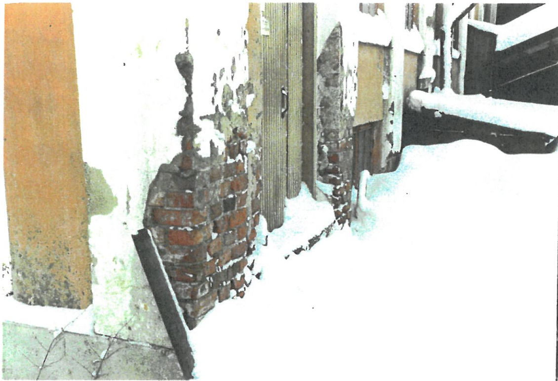
Kuva 6. Vaurioitunutta ulkoseinän rappauspintaa myllyrakennuksen koillisnurkalta.
