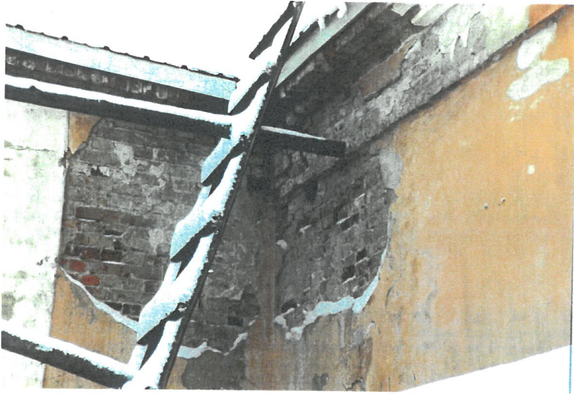
Kuva 9. Vesikattovuodon ja sadevesijärjestelmän pettämisen seurauksena rappaus on irronnut entisen kattila- ja konehuoneen liitoskohdasta.
