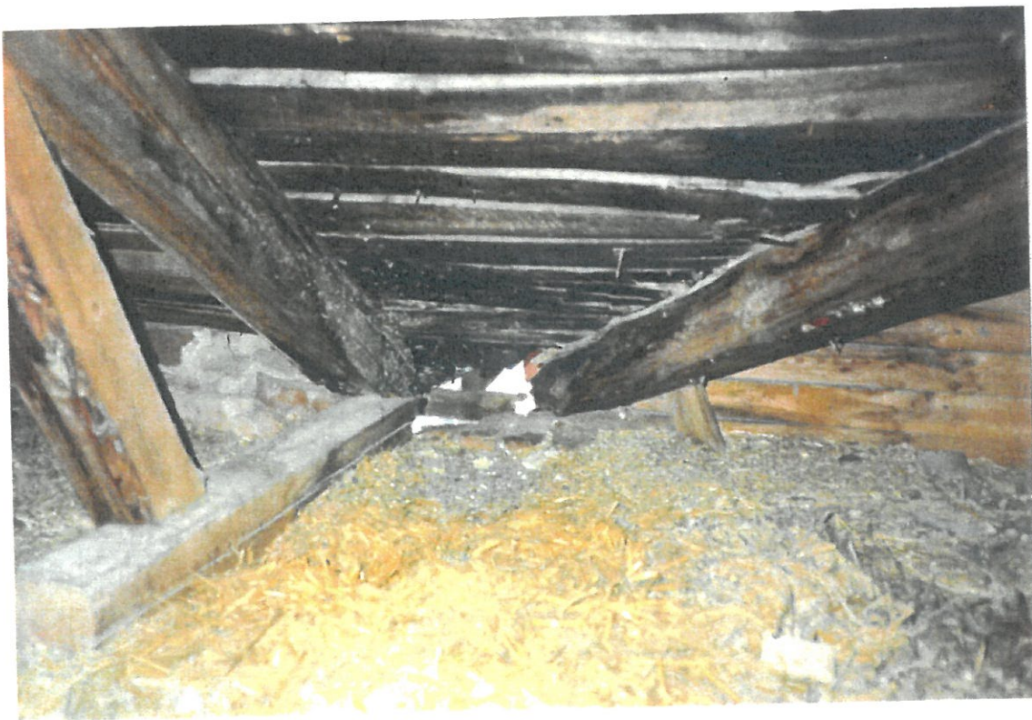
Kuva 17. Pahimmat vesikatteen alustarakenteiden lahovauriot sijaitsevat kattilahuoneen ja konehuoneen kulmauksen yläpuolisessa jiirissä. Alempi ruodelaudoitus ja kattokannattajien alapäät ovat täysin lahoja. Laakakääpäkasvustoa esiintyy paikoin lahonneiden puurakenteiden pinnalla.
