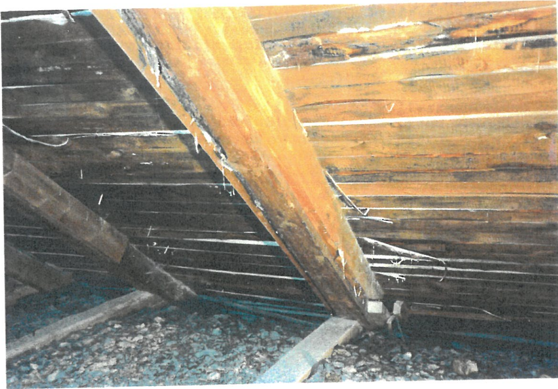
Kuva 16. Vesikattokannattajien lahovaurioita ja painumia on korjattu kannattajien kylkeen naulatuilla soiroilla. Kuvassa vahvistettuja vesikattokannattajia toimistotilan 202 itäpuolen lappiolta.
