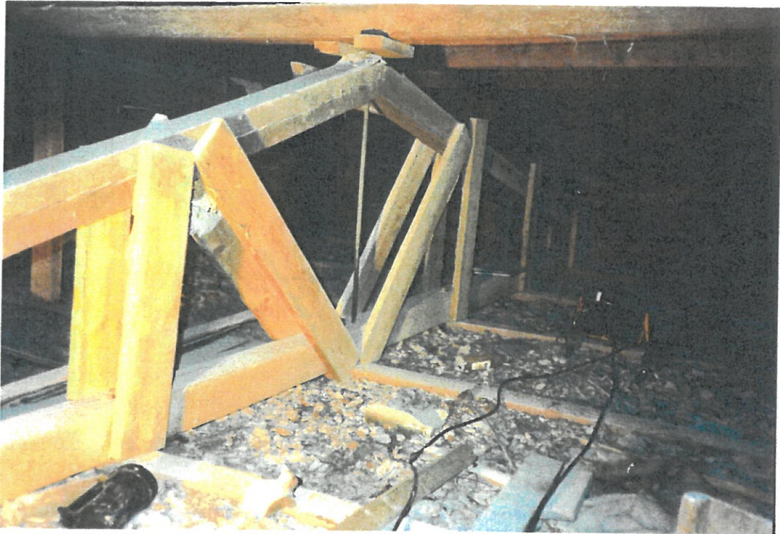
Kuva 12. Toimistotilan 202 yläpohjarakenteen kannattajia tukeva yläpuolinen ristikkorakenne on taipunut alaspäin "aukon" keskellä lähes 100 mm:iä. Kuvassa näkyy myös ko. yläpohjarakenteen turpeella ja sammalella eristettyä rakennetta.
