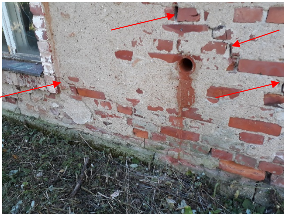
Kuva 28. Julkisivuporaus US1. Julkisivurappaus oli kohdalla pudonnut seinältä alas. Avauskohdan vierellä tiilisaumoissa esiintyy ratkeilua (punaiset nuolet).
