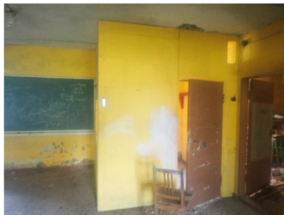
Kuva 37. Seinien ja väliovien pinnoitteet ovat kuluneet.
