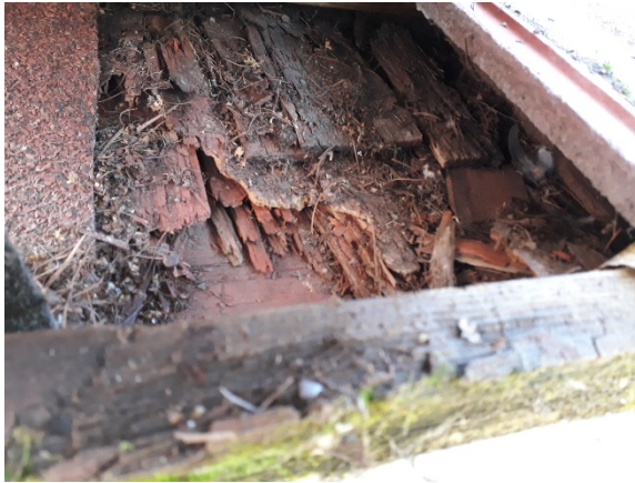
Kuva 54. Tiilikatteen alla oleva pärekatto on paikoin lahonnut.
