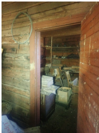
Kuva 40. Hirsirakenteisen seinän pinnat ovat tummu- neet ja välioven pinnalla näkyvissä lintujen ulosteita. Kuva on toisesta kerroksesta.
