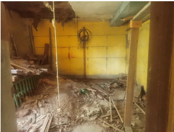
Kuva 46. Välipohja on romahtanut.
