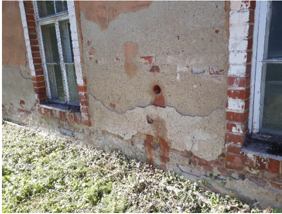
Kuva 30. Julkisivuporaus US2. Julkisivurappaus oli kohdalla suurelta osin pudonnut seinältä alas. Jäljellä oleva rappaus oli heikosti kiinni ja rapautunutta.
