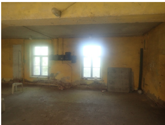
Kuva 36. Kivirakenteisissa seinissä rappaukset ovat huonokuntoisia.
