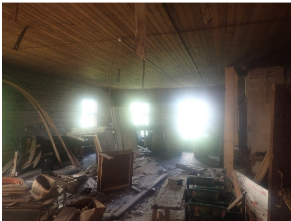
Kuva 3. Yleiskuva yläkerrasta. Katto on taipunut.
