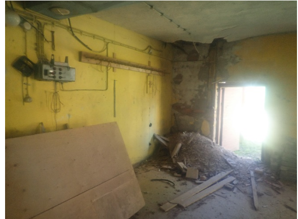
Kuva 45. Välipohja on romahtanut. Kuva on viereisen kuvan kohdalta alakerrasta.
