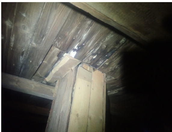
Kuva 50. ilmanvaihtohormin läpiviennin vierustalla nä- kyvissä kosteus- ja mikrobivaurioita.
