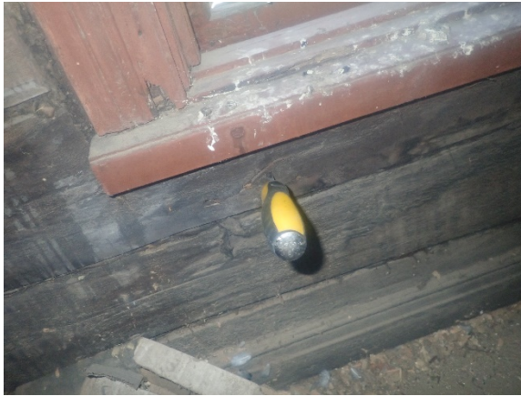
Kuva 26. Hirsiseinässä lahovaurioita. Kuva on etupihan puoleisen ikkunan kohdalta. Hirsien pinnalla näkyvissä valumajälkiä.
