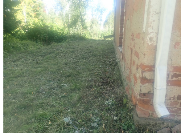
Kuva 57. Maanpinnan kallistukset ovat loivat. Kuva on etupihalta katsottuna vasemmanpuoleisesta päädyestä.
