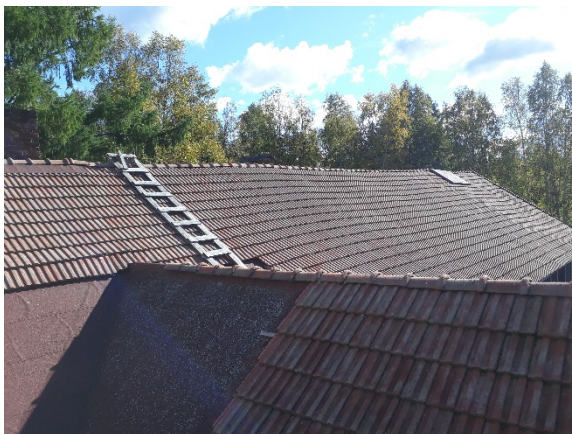
Kuva 52. Yleiskuvaa vesikatolta. Harja on painunut.
