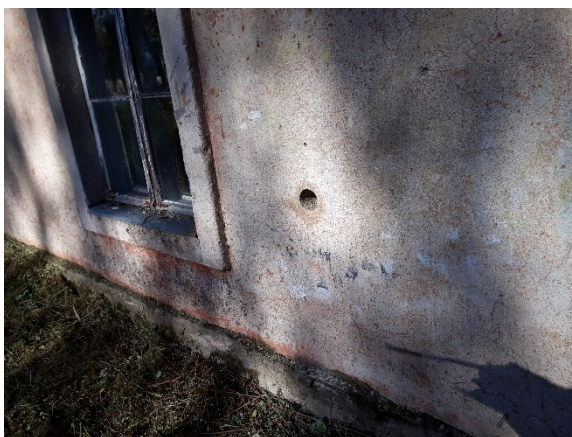
Kuva 32. Julkisivuporaus US3. Julkisivurappaus oli halkeillutta ja kulunutta.
