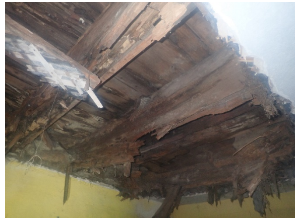
Kuva 47. Välipohjan kantavat palkit ovat lahonneet ja erittäin huonokuntoisia. Kuva on viereisessä kuvassa näkyvän aukon kohdalta.
