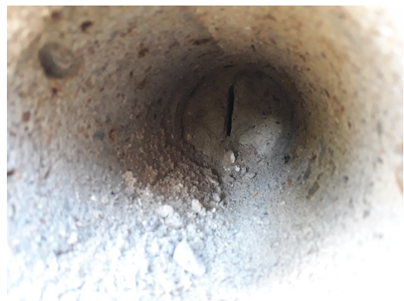
Kuva 33. Kuva avauksesta US3. Betoniharkkojen saumalaasti oli hiekoittunutta ja harkkojen välillä oli avoimia rakoja.
