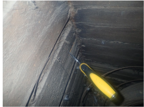
Kuva 27. Ulkoseinien liittymässä ja sen läheisyydessä hirsissä lahovaurioita. Kuva on etupihan ja päätyseinän liittymästä.
