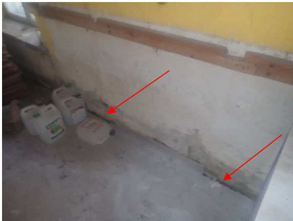
Kuva 6. Alapohjan ja ulkoseinän liittymässä rako.
