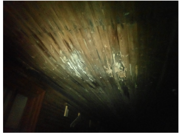
Kuva 49. Yläpohjan rakenteet ovat vaarassa romah- taa alas. Kuva on takapihan puoleiselta sivustalta.
