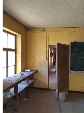
Kuva 39. Väliovet ovat kunnostuksen tarpeessa.
