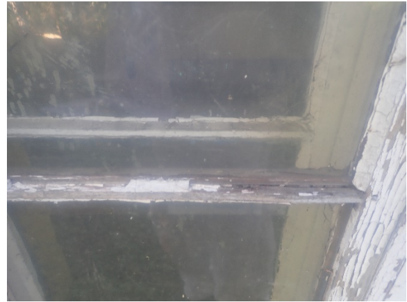
Kuva 21. Ikkunoiden puuosat ovat huonokuntoisia.
