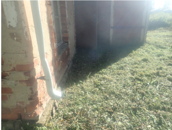
Kuva 56. Maanpinnan kallistukset ovat puutteelliset ja ulkoseinien alaosien puuosat ovat maanpinnan tasolla tai sen alapuolella. Kuva on etupihan puolelta.
