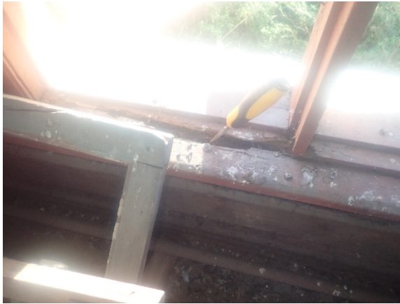
Kuva 20. Ikkunan karmin alapuussa ja sen alapuolella olevassa hirressä lahovaurioita. Kuva on takapihan puolelta.
