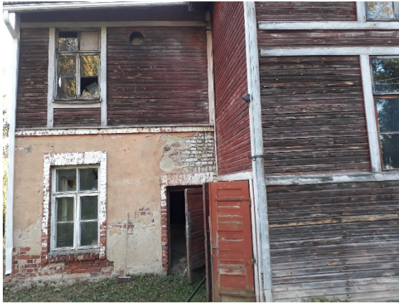
Kuva 14. Yleiskuva sisäänkäynniltä. 1.kerroksen rappaus on irronnut alustastaan ja 2.kerroksen puuosien maali on kulunut.
