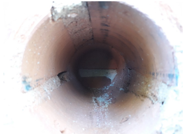
Kuva 29. Kuva avauksesta US1. Tiilisaumat ovat rapautuneita ja tartunnassa on rakoilua.
