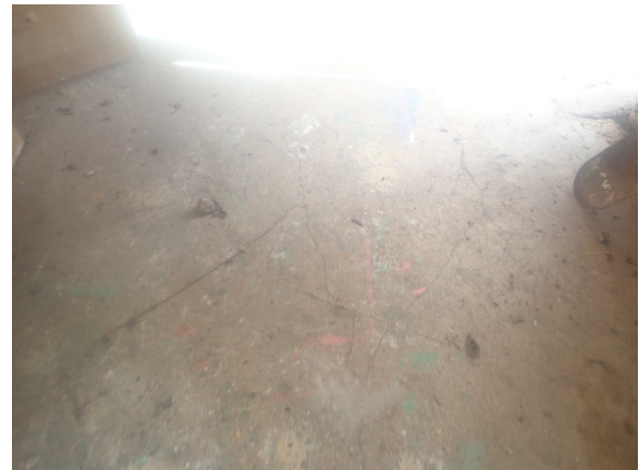
Kuva 7. Betonilaatassa halkeamia. Kuva on rakennuksen päädyssä olevan ovi-aukon kohdalta.
