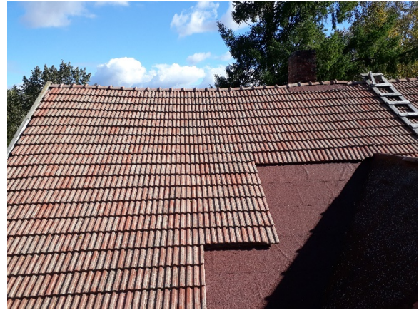
Kuva 55. Harjan taipumaa sisäänkäynnin kohdalla.
