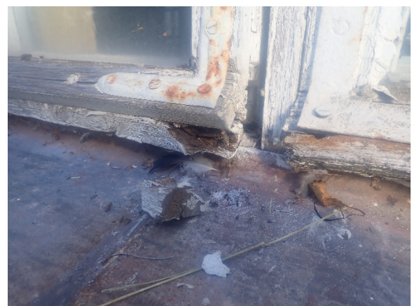
Kuva 19. Ikkunan puitteen alapuussa lahovauriota.
