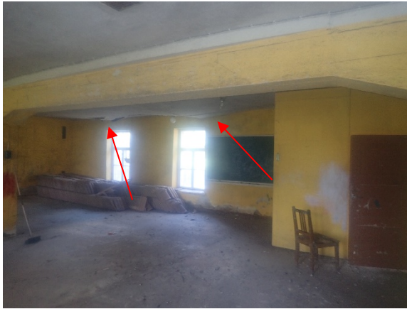
Kuva 48. Välipohjan rakenteet ovat vaarassa romah- taa alas.
