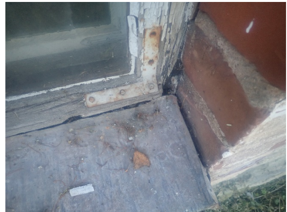
Kuva 17. Ikkunan liittymien ja vesipeltien liittymät eivät ole tiiviitä. Vesipeltien kallistukset ovat loivat. Puuosat ovat huonokuntoisia.
