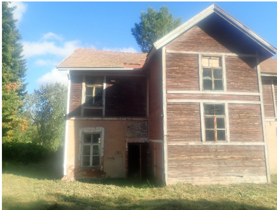
Kuva 62. Maanpinta on puurakenteisten ulkoseinien alaosien yläpuolella etupihan puolella.
