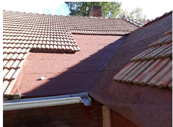
Kuva 53. Jiiriä on paikattu kattuhuovalla.
