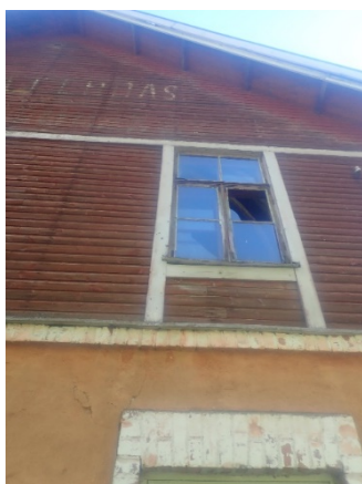
Kuva 18. Yläkerran ikkuna on rikkoutunut. Julkisivuverhous on kulunut.
