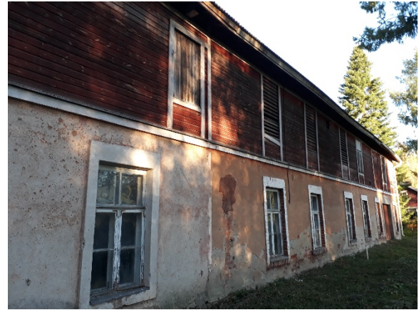
Kuva 15. Yleiskuvaa julkisivusta takapihan puolelta. Rappaus on huonokuntoinen.
