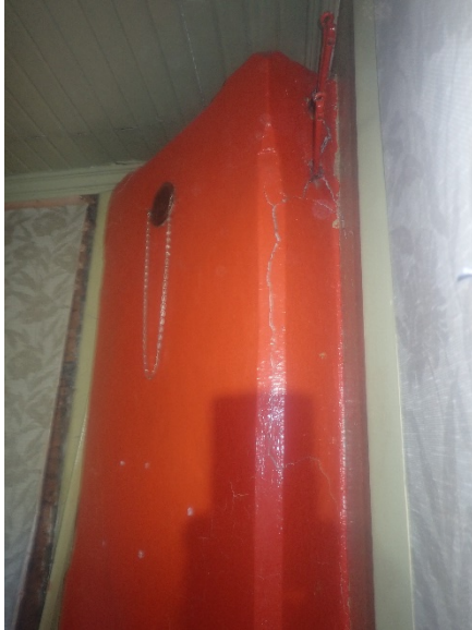
Kuva 54. Korkealla osalla olevan tulisijan muuraukset ovat halkeilleet.
