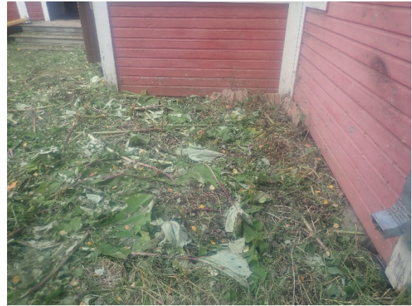
Kuva 75. Maanpinnan kallistus on puutteellinen ja ulkoseinien alaosien puuosat ovat maanpinnan tasossa ja paikoin jopa sen alapuolella. Kuva on matalan osan etupihan puolelta.
