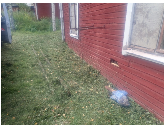
Kuva 14. Etupihan puolella painumisen johdosta julkisivulaudoituksen alimmaisista lautoja on jäänyt maanpinnan alapuolelle.
