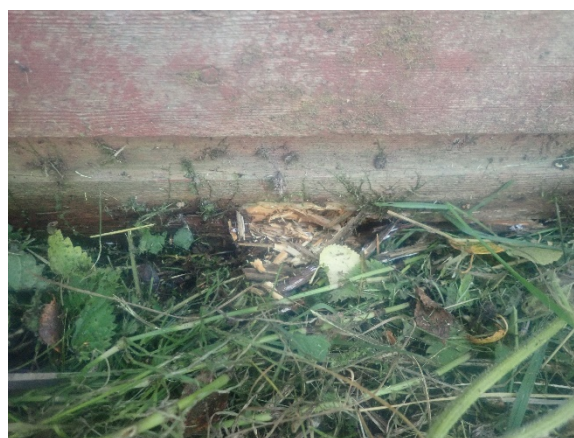
Kuva 15. Julkisivulaudoituksessa lahovaurioita. Kuva on otettu rakennuksen päädyistä.
