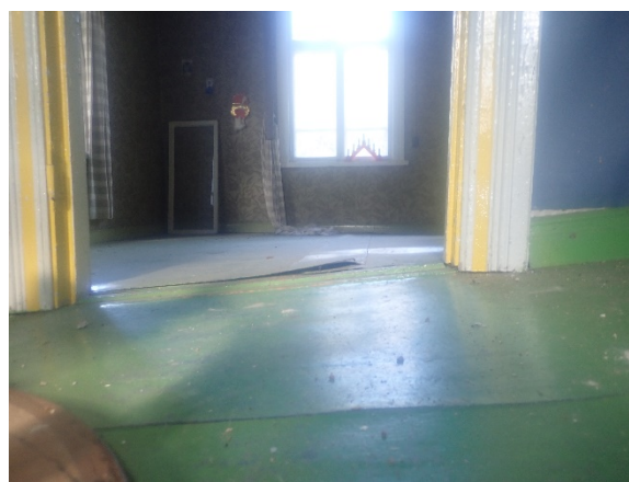
Kuva 41. Välipohja on painunut ja vinossa.
