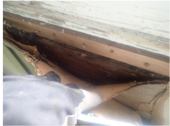
Kuva 45. Ulkoseinän sisäpuolen laudoituksessa ikkunan alla kosteusjälkiä. Kuva on otettu viereisessä kuvassa näkyvän ikkunan alapuolelta.
