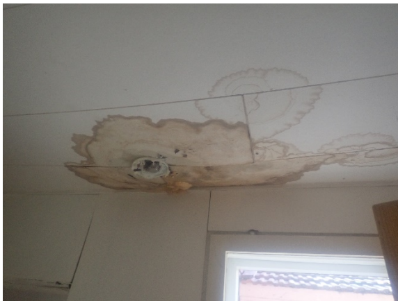
Kuva 46. Kattolevyissä kosteusjälkiä ja mikrobikasvustoa.
