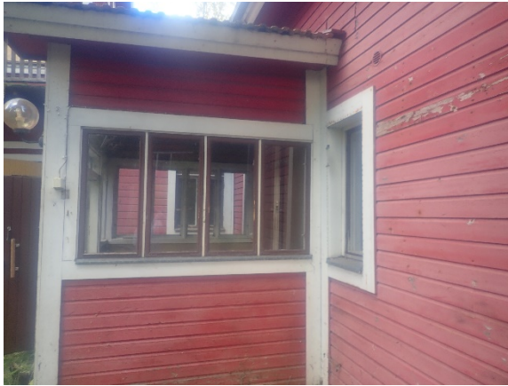
Kuva 18. Matalan osan julkisivua etupihan puolella. Puuosissa näkyvissä rispaantumista.
