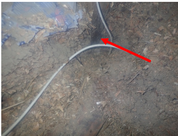
Kuva 68. Rakenneavaus YP3 tehtiin päätyseinän läheisyyteen. Ulkoseinän runkotolpassa tummentumaa.
