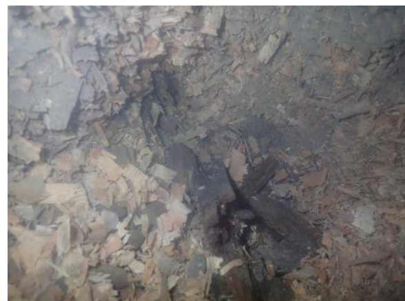
Kuva 6. Laudat olivat pahoin lahovaurioituneita rakenneavauksen AP1 kohdalla.
