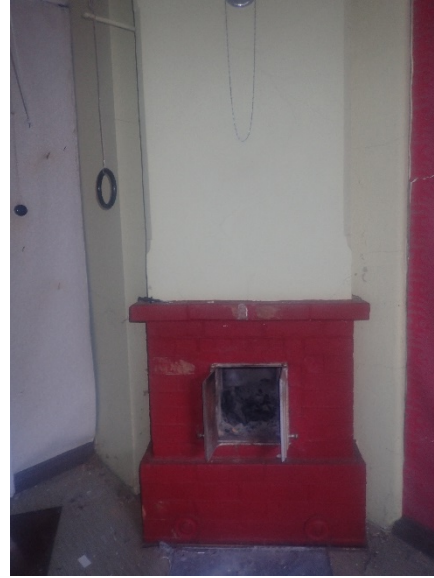
Kuva 55. Korkealla osalla olevan tulisijan muuraukset ovat halkeilleet.
