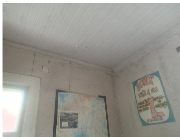
Kuva 43. Seinäpinnoilla näkyvissä kosteus- /valuma-jälkiä. Kuva on ensimmäisestä kerroksesta.
