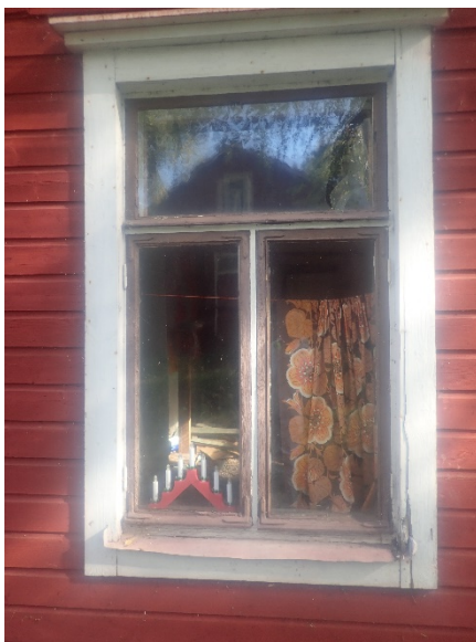
Kuva 20. Yleiskuva korkean osan ikkunoista. Lasi on rikkoutunut ja smyggilauta on lahovaurioitunut.
