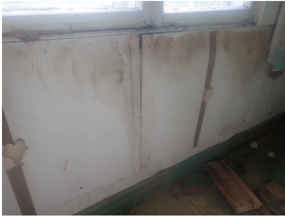
Kuva 44. Ulkoseinällä toisessa kerroksessa portaikossa ikkunan alla kosteus- /valumajälkiä.
