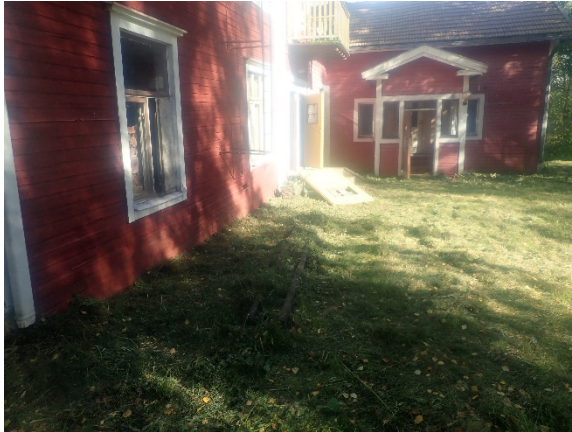
Kuva 70. Maanpinnan kallistukset ovat puutteelliset ja ulkoseinien alaosien puuosat ovat maanpinnan tasolla tai sen alapuolella. Kuva on etupihan puolelta.
