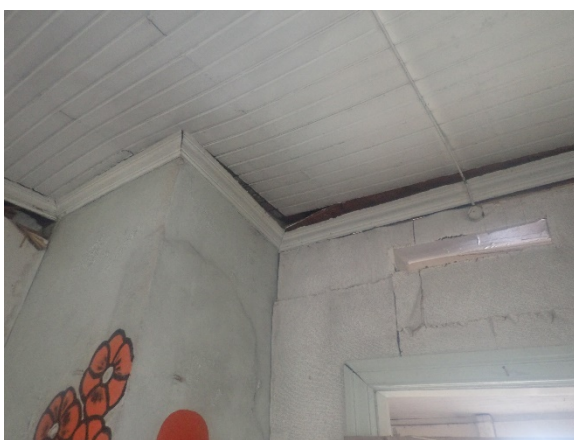
Kuva 40. Väliseinä ja välipohja ovat painuneet.
