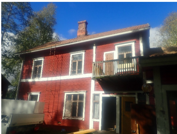
Kuva 12. Yleiskuva julkisivuverhouksesta etupihan puolelta. Vasen nurkka on selkeästi painunut.
