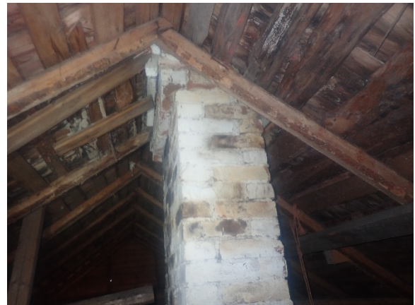
Kuva 62. Savupiipun läpiviennin ympärillä vesikatteen alapuolisissa puuissa kosteusjälkiä. Kuva on korkealta osalta.
