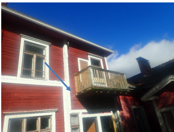
Kuva 16. Parvekkeen läheisyydessä julkisivuverhouksessa vaurioita. Parvekkeen pohjalevy on taipunut ja kaiteet heikkokuntoiset.
