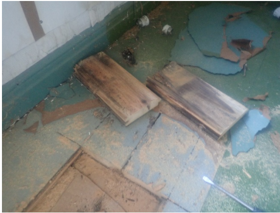
Kuva 48. Rakenneavauksen VP2 kohdalla välipohjan lattialautojen alapinnassa kosteusjälkiä ja tummentumia.
