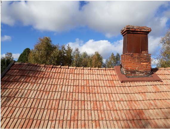
Kuva 57. Etupihan puolelta katsottuna lape ja harja ovat taipuneet korkealla osalla.
