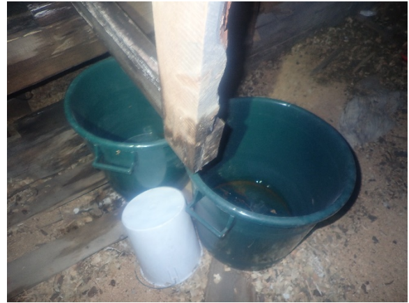
Kuva 64. Vesikate vuotaa jiirin kohdalla. Kuva on matalalta osalta.
