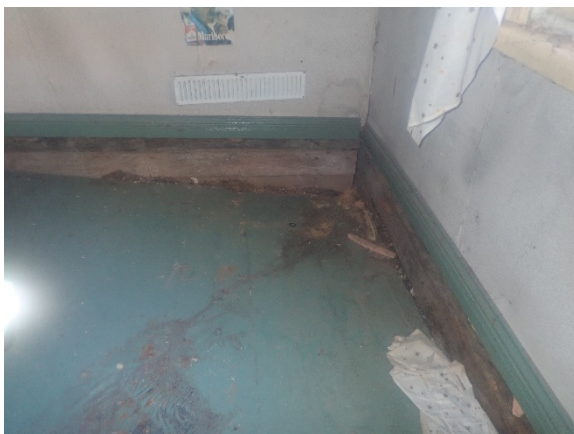
Kuva 1. Alapohjarakenteet ovat tippuneet maanpintaa vasten. Kuva on korkealta osalta.
