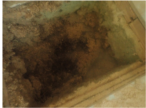
Kuva 9. Lämmöneristeet olivat alhaalta kosteita ja niiden alla olevat laudat märkiä. Kuva on rakenneavauksen AP3 kohdalta.
