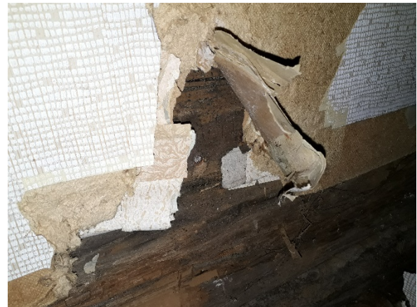
Kuva 37. Avauksen US6 kohdalla seinän sisäpinnassa on useampi kerros erilaisia pintamateriaaleja.
