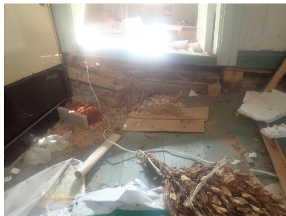
Kuva 2. Alapohjarakenteet ovat tippuneet maanpintaa vasten. Kuva on korkealta osalta.
