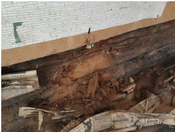
Kuva 36. Yleiskuva ulkoseinän rakenneavauksen US6 kohdalta rakennuksen takaa korkealta osalta. Avauskohdalla hirsissä on lahovaurioita ja jälkiä tuholaishyönteisistä.
