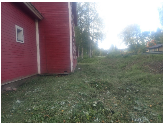
Kuva 72. Maanpinnan kallistukset ovat loivat ja osin rakennukseen päin. Ulkoseinien puuosat ovat maanpinnan alapuolella korkealla osalla. Kuva on maantien puolelta.
