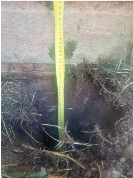
Kuva 26. Perustukset ja ulkoseinärakenne ovat painuneet runsaasti.
