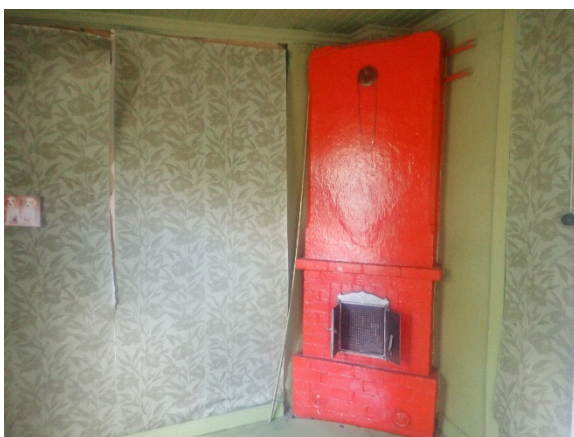
Kuva 42. Väliseinien pinnoitteet irtoilevat.
