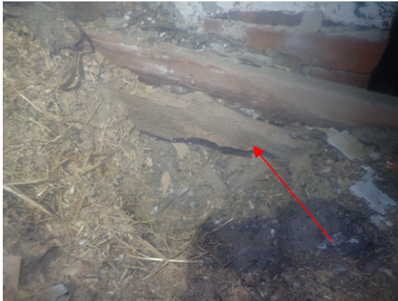
Kuva 69. Rakenneavaus YP4 tehtiin savupiipun läheisyyteen. Savupiipun ympärillä olevassa laidoituksessa lahovaurioita.
