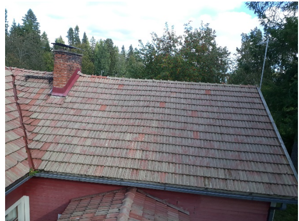
Kuva 60. Myös matalan osan vesikatto aaltoilee ja on taipunut.
